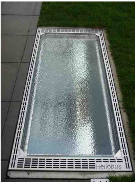
Daylight Shaft mit Kondensat
